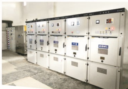
高低压配电柜
